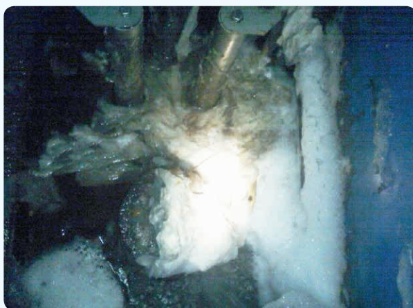
Durch Feuchttücher verstopfte Pumpe Pump clogged by wipes
