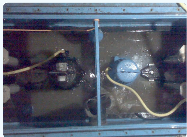
Nach Einbau der neuen Pumpe in den Behälter After installing the new pump in the container
